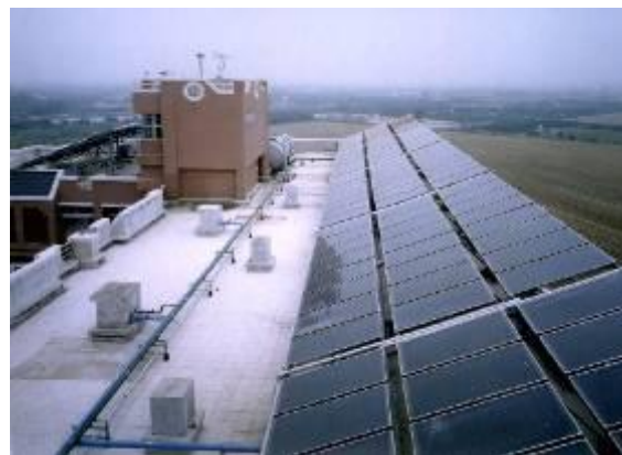
台南縣致遠管理學院 太陽能熱水系統 安裝面積: 307.5平方公尺 (供 450位學生使用)
